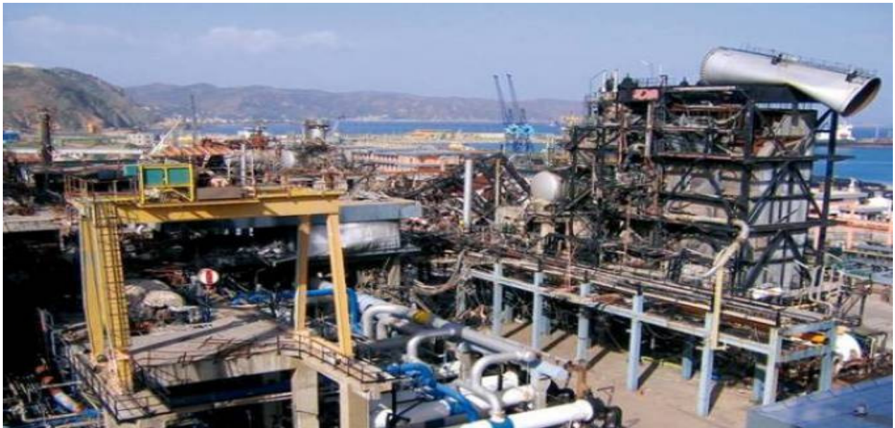
Figure (1-1) : Centre d'enfûtage GPL de Skikda après l'accident
