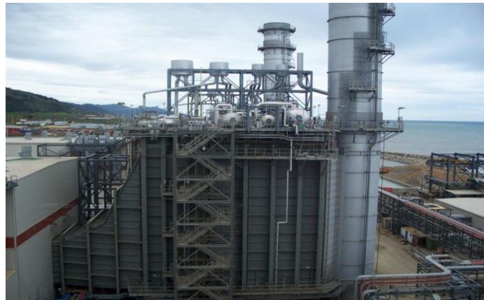
Figure II-6 : Photo d'une Chaudière
