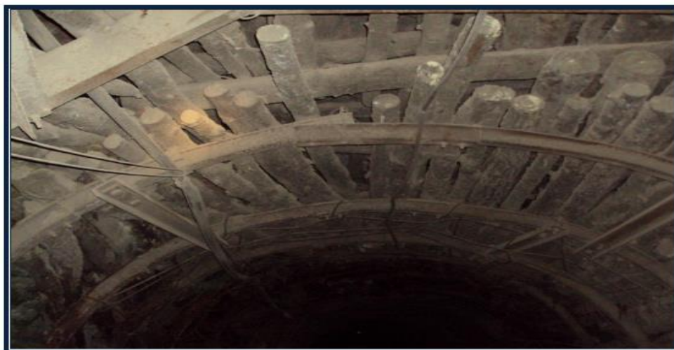
Figure 29 : Soutènement par cintres métalliques (la mine de Chaabat EL-Hamra)
