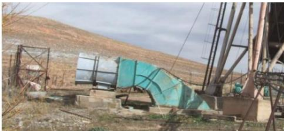
Figure 26 : Ventilateur aspirant de Chaabat El Hamra.
