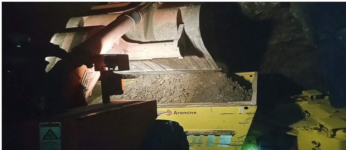
Figure 35 : Chargement du camion aramine T1600 par la chargeuse LH203 à proximité de la niche
