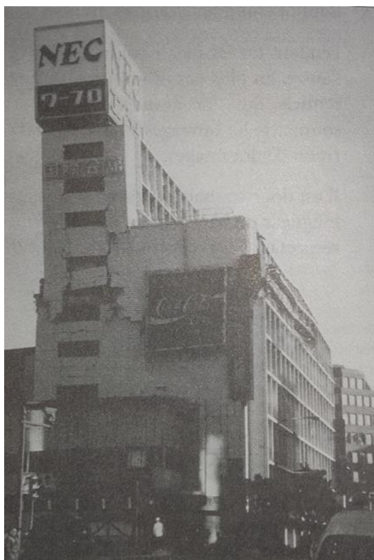
Figure 2.9 : Dommages dus à la présence de niveaux en retrait [1]
