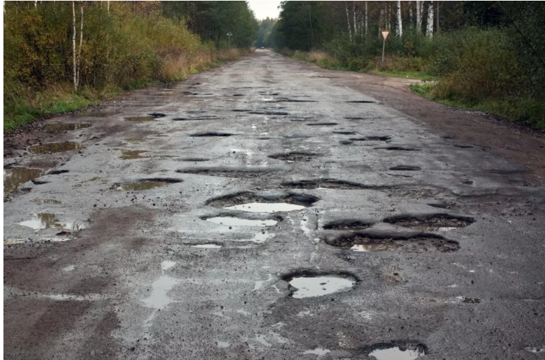
FIGURE I.2 – L'effet de l'eau sur la route[19]
