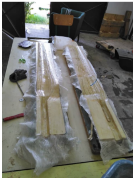
FIGURE 5.15 – Renforcement de la structure avec le tissu de roving et les mâches
