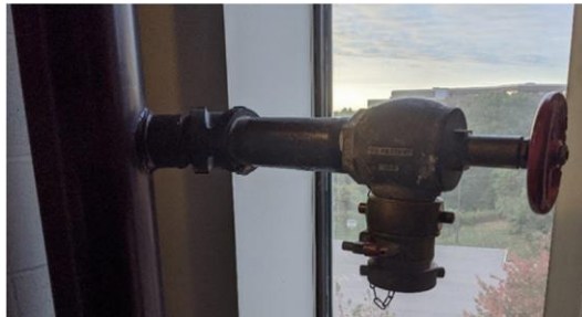
Figure 3-1: Colonne montante Classe I. [19]
