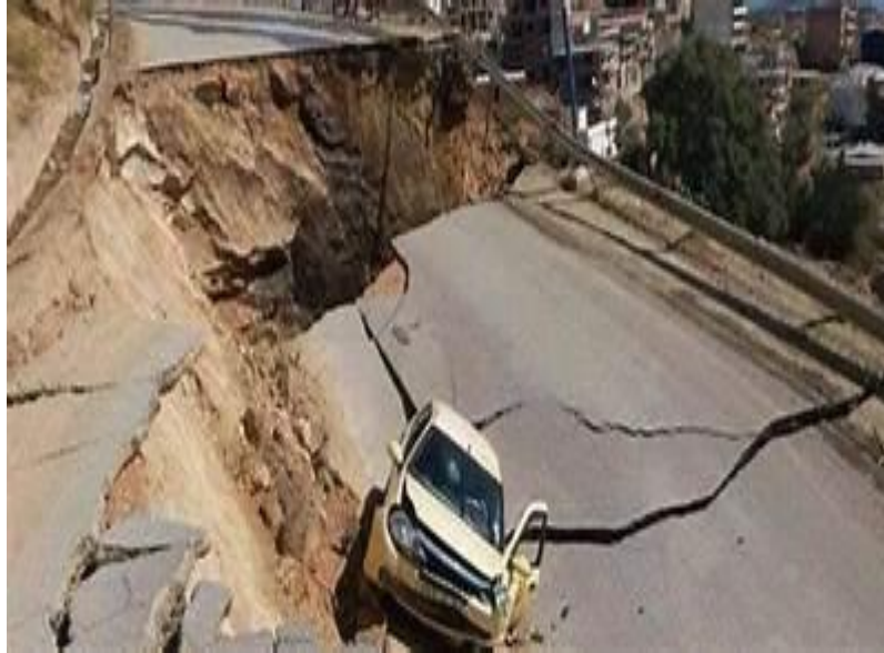
Figure 1.9 : Glissement dans le quartier de Sidi Aissa sur la bretelle Kouba à Ain Achir [11]
