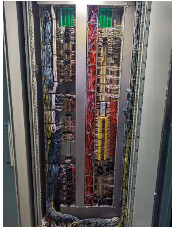
FIGURE 2.14 – Face arrière de l'armoire (marshaling)
