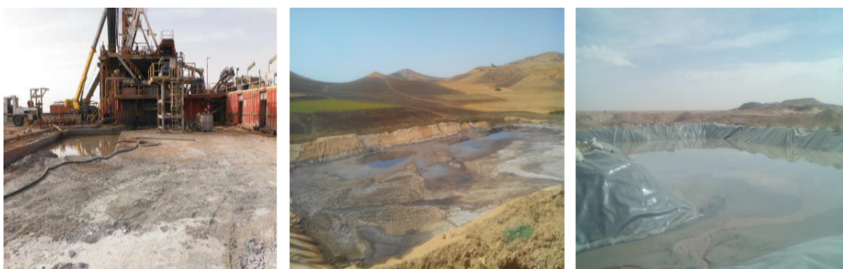
FIGURE 4.7 – Plateforme de forage avec HPWBM [SONATRACH 2023]
