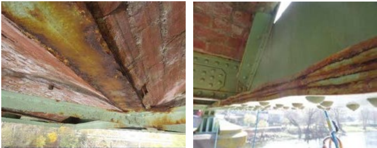
(a) Corrosion superficielle des poutrelles
