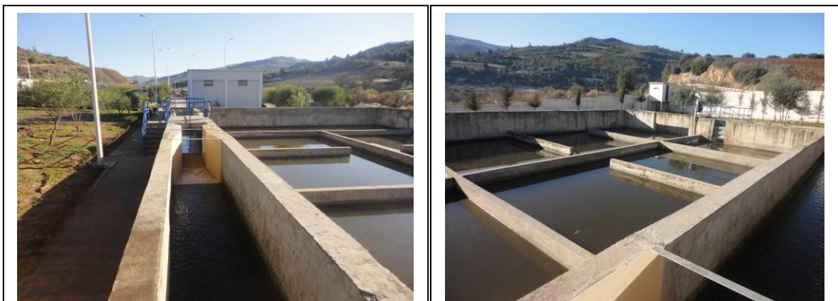
Figure III.6 : Canal de comptage et bassin de chloration de la STEP de Médéa
