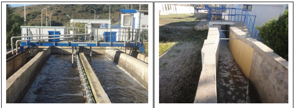
Figure III.3 : Dessableur - déshuileur et chenal de comptage de la STEP de Médéa
