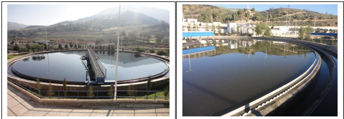
Figure III.5 : Décanteur Secondaire de la STEP de Médéa
