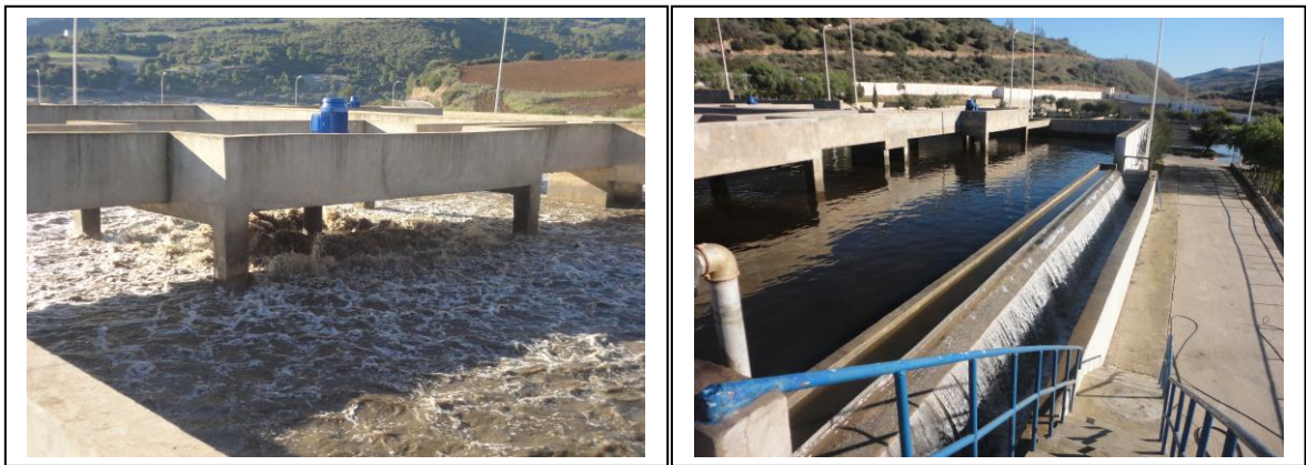
Figure III.4 : Bassin d'aération de la STEP de Médéa
