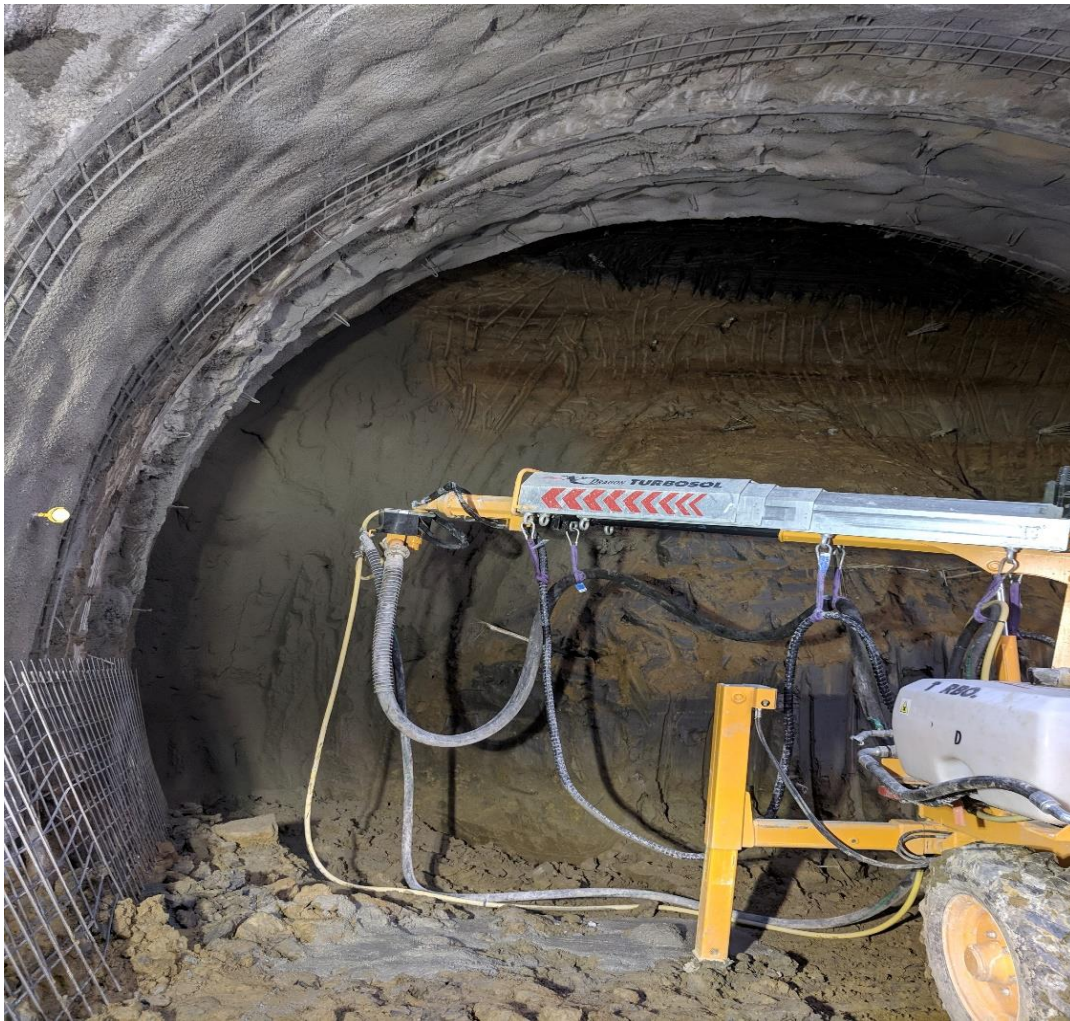
Figure 2.11- L'injection de la couche du béton projeté sur le front de taille par voie humide
