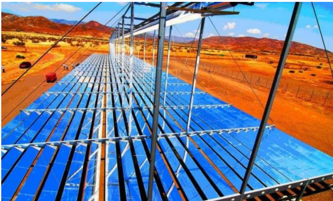
Figure 1.14 : Centrale solaire thermique à miroirs de Fresnel
