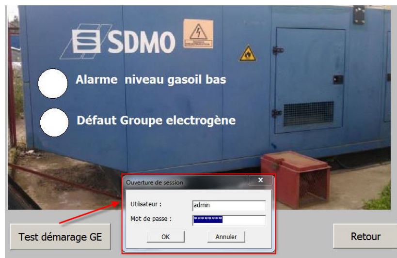
Figure IV. 31. Protection de la commande par mot de passe
