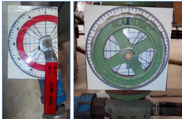
Figure III.10: Vanne d'air, et vanne de dosage avec plaques gradué installé pour l'étude
