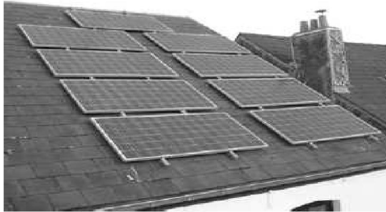
Figure I.5 : Panneaux PV connectés au réseau et montés sur la toiture d'un bâtiment.
