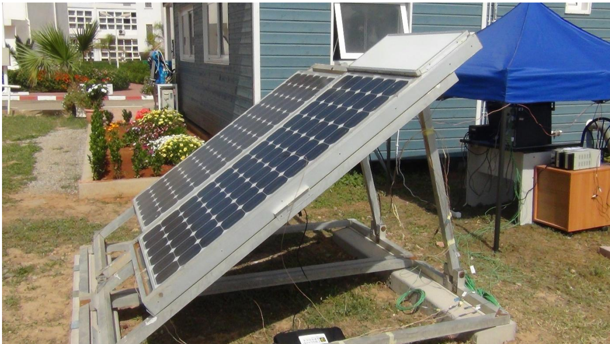
Figure IV.1 : Photo du capteur PVT : capteur PV témoin orienté à 30° au sein de l'UDES.
