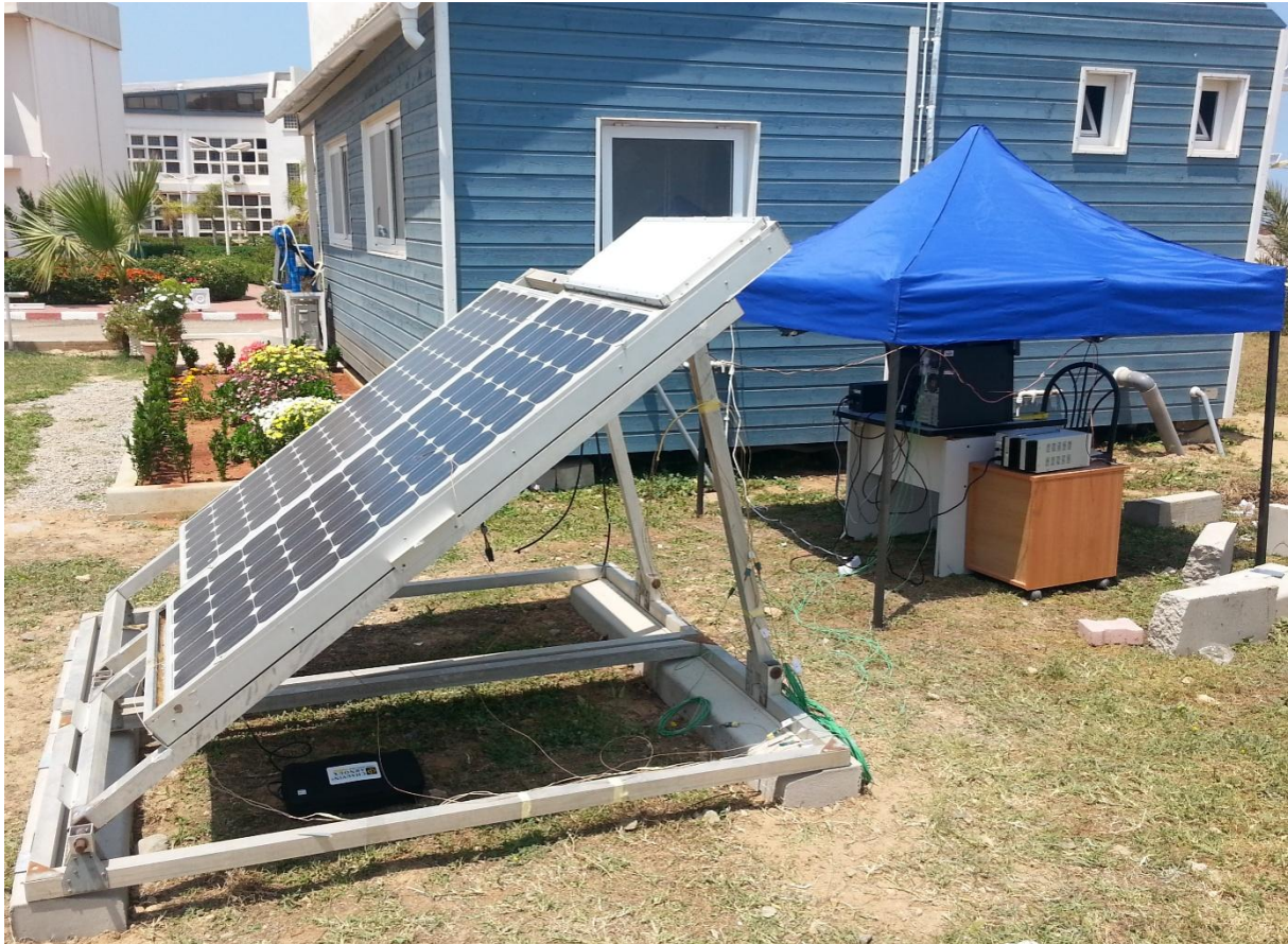
Figure VI.13 : Installation expérimentale en mode opératoire.
