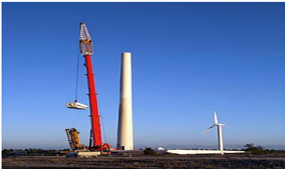
Figure 1.9: le mât autoporteur d'une éolienne
