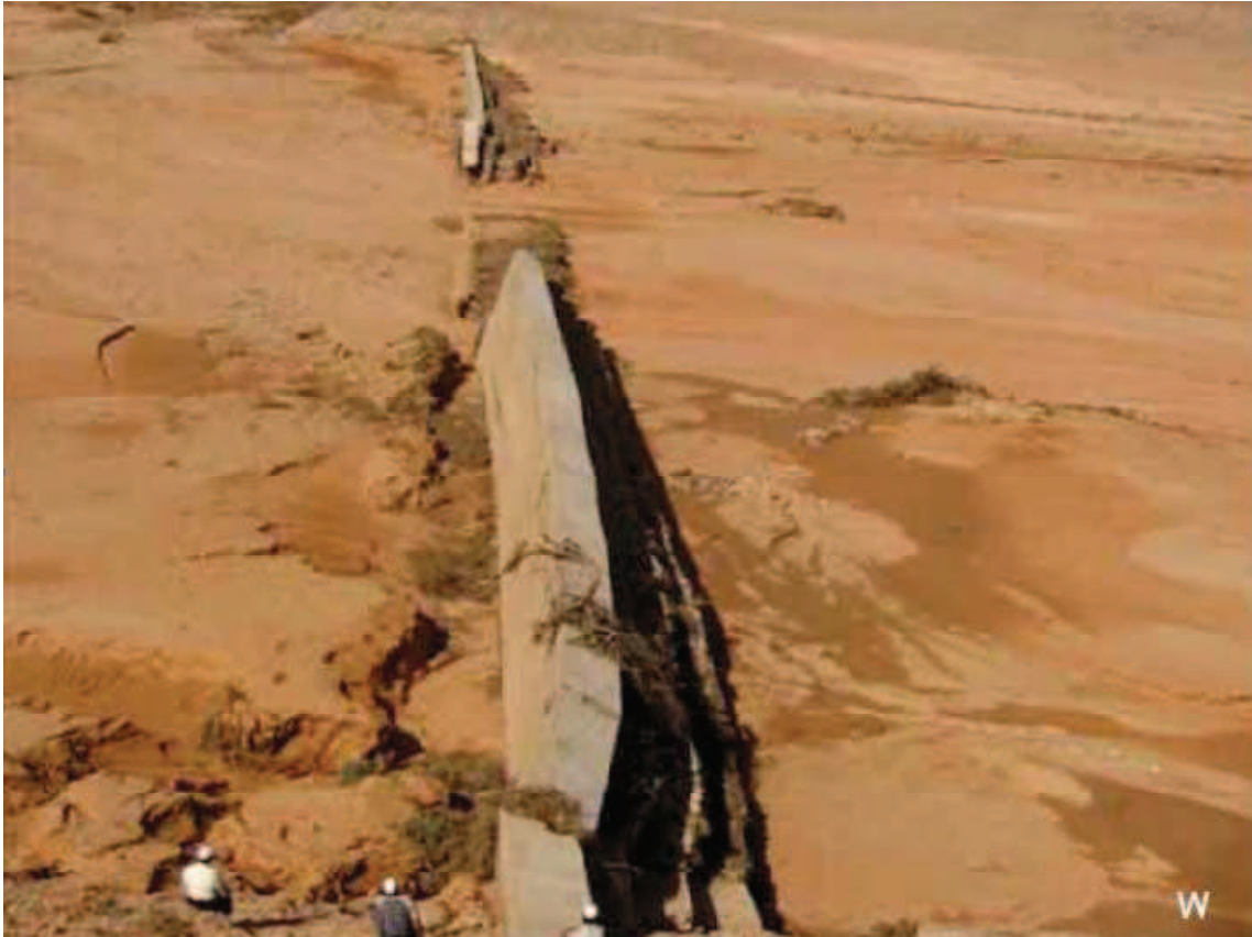
Photo III.8 : Destruction du barrage El Haimeur par la crue ( Djellouli-Tabet, Y )
