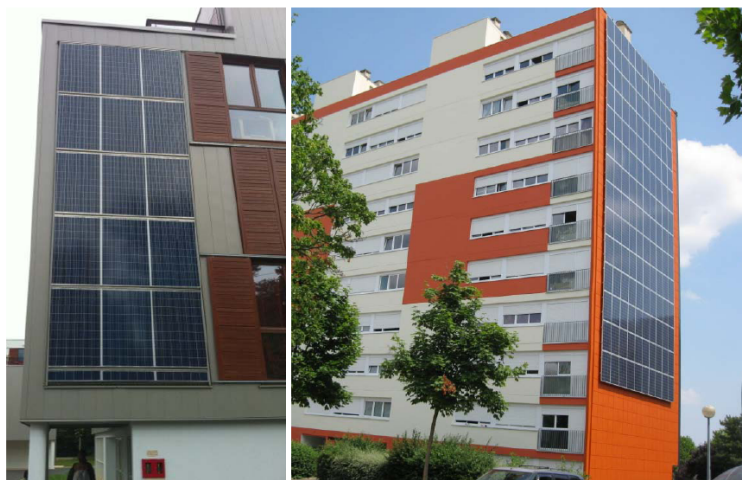
FIGURE I.7 – système photovoltaïque en bardage
