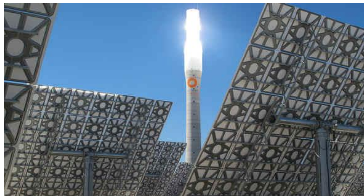
Fig. I. 9 : La centrale GEMASOLAR à Séville (sud de l'Espagne.)
