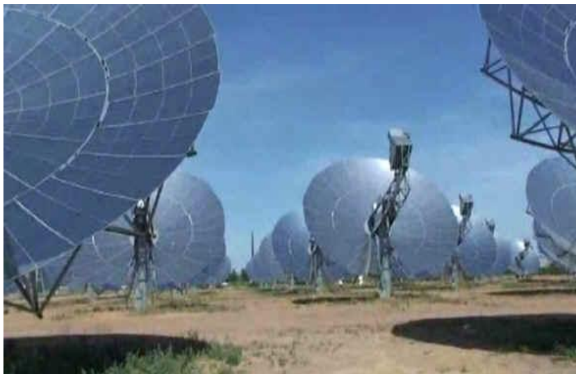
Fig. I. 7 : Le Maricopa Solar project réalisé par Stirling Energy Systems
