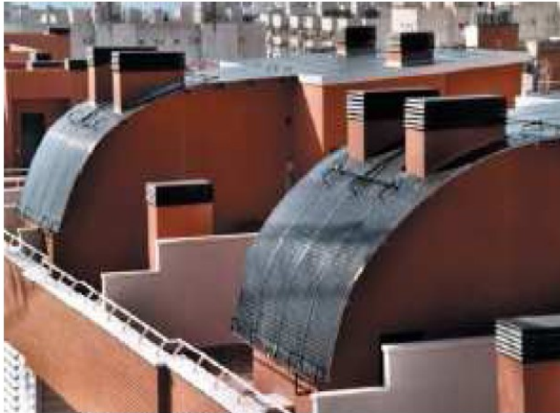
Fig. III.3: Installation de production d'eau chaude sanitaire
