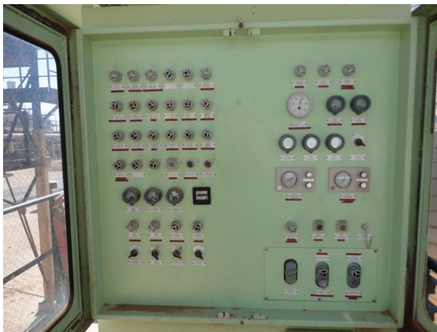
Figure III.2 photo du panneau local de la machine
