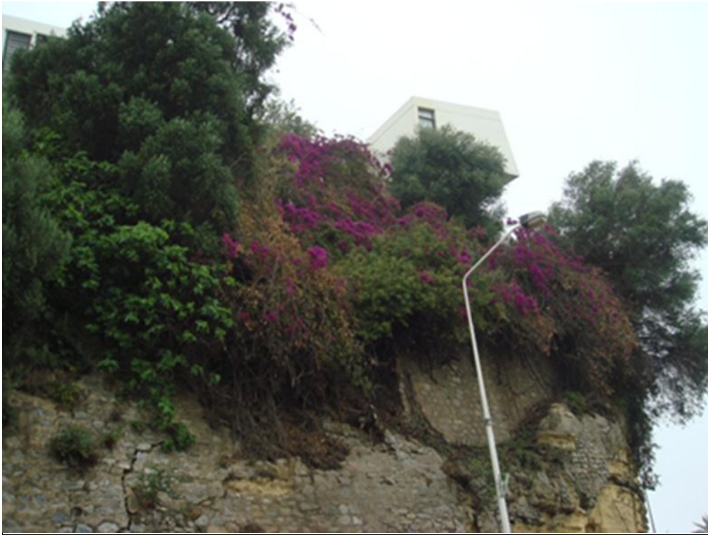
Photo 8-3 : Habitations en danger sur le Balcon de Saint-Raphaël.
