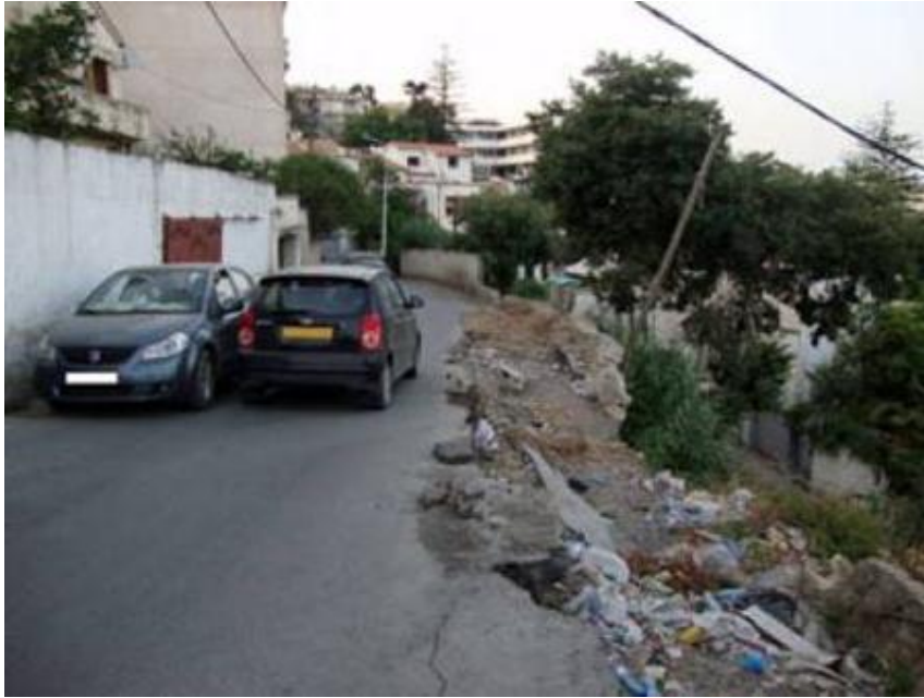
Photo 3-1 : Glissement du bord de la route Sfindja
