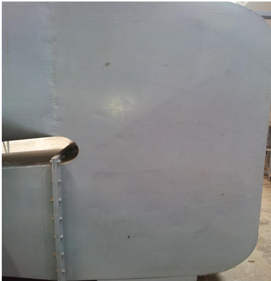
Figure.I.7 : la canalisation qui relie les deux parties de la soufflerie
