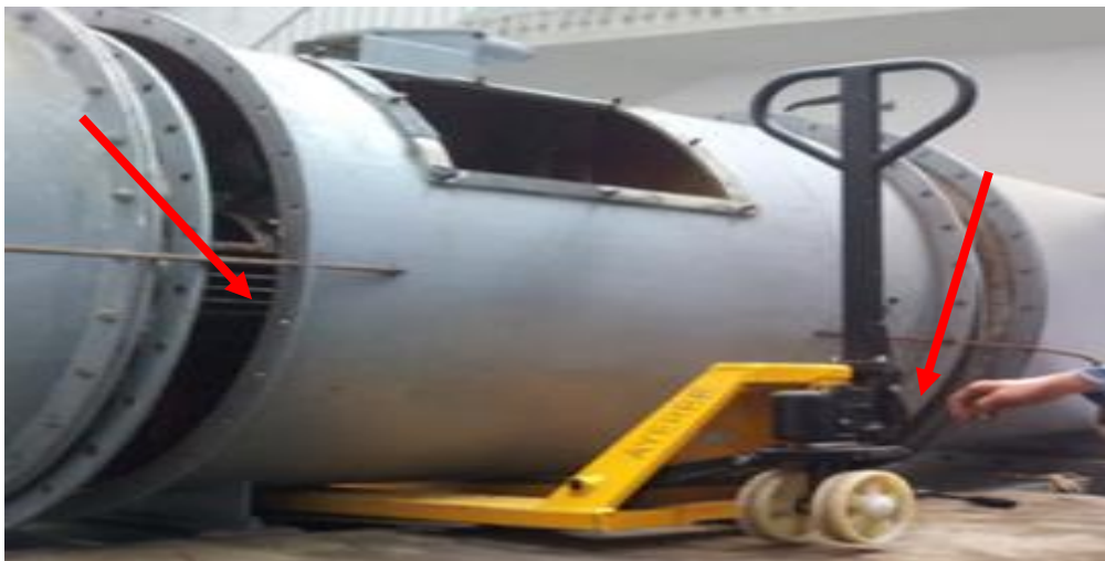
Figure.IV.7: une image montrant les barreaux qui empêchent la chute du cylindre vers l'autre côté.
