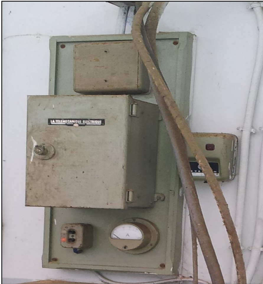
Figure. III.2 :L'ancienne armoire électrique
