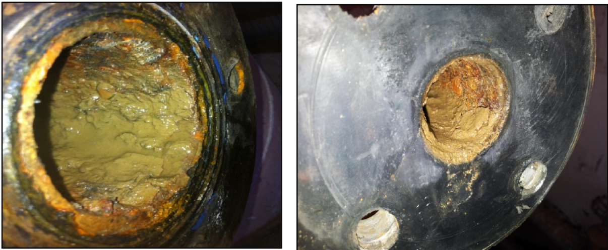
Figure II-5 : A la sortie du réservoir : corrosion et absence de filtres
