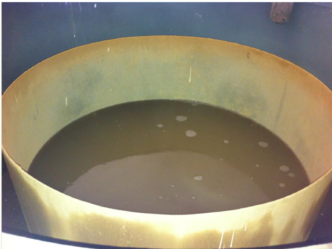
Figure II-3 : L'eau est boueuse dans le réservoir
