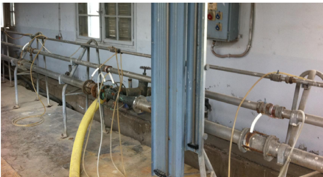
Figure II-9 : L'état des flexibles avant de procéder à leur remplacement
