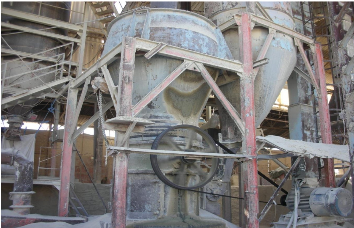
Silo tampon pour stockage de tout venant dopé et séché.
