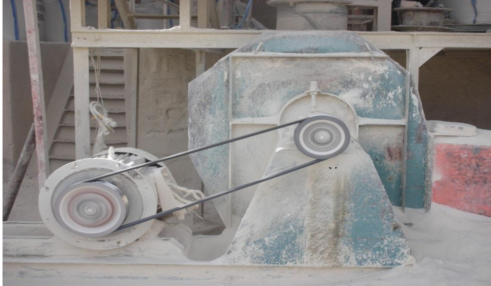
Un ventilateur principal de broyeur.
