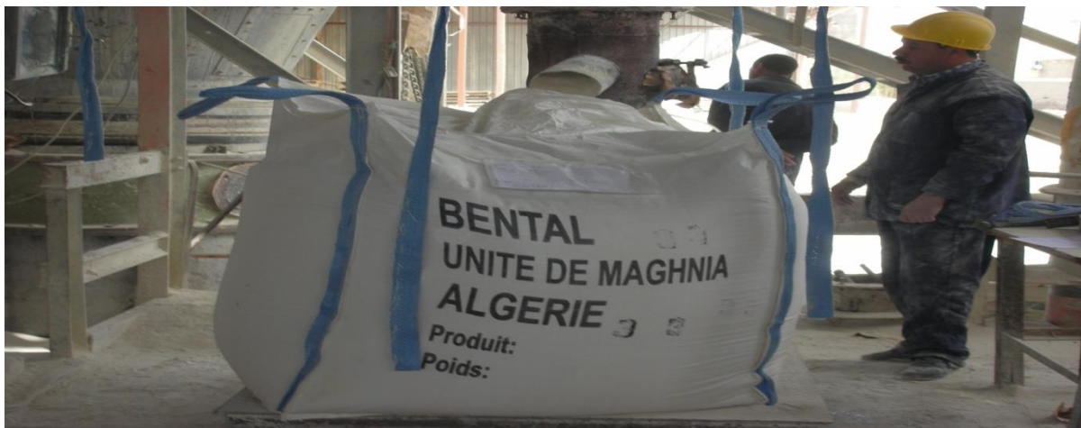
Une ensacheuse directement connectée sous ce cyclone : L'écoulement de la poudre se fait par injection d'air produit par un compresseur gonfleur.
