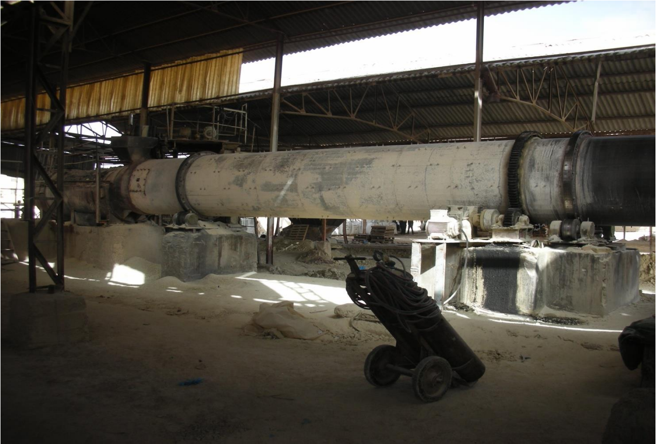
Séchoir rotatif composé de trois parties : chambre de combustion, virole et décharge de minerais
