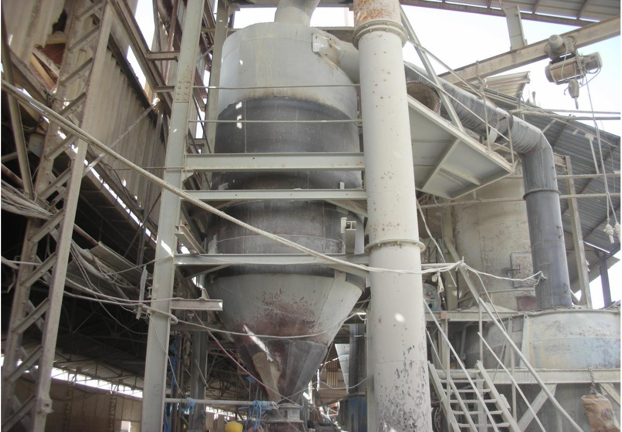
Un cyclone servant également de silo de récupération de matière première broyée.
