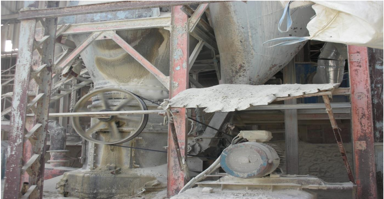
Distributeur asservi qui règle le débit d'alimentation de broyeur.
