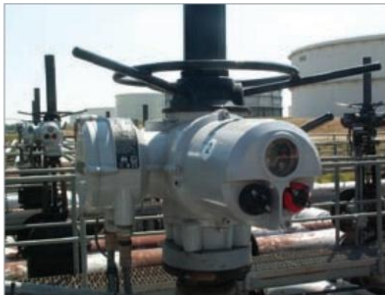
Figure II.13 : Vue d'une électrovanne.
