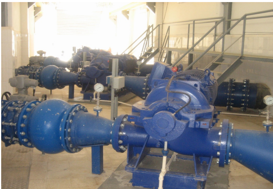
Figure III.3 Vue de générale des groupes électropompes [1]
