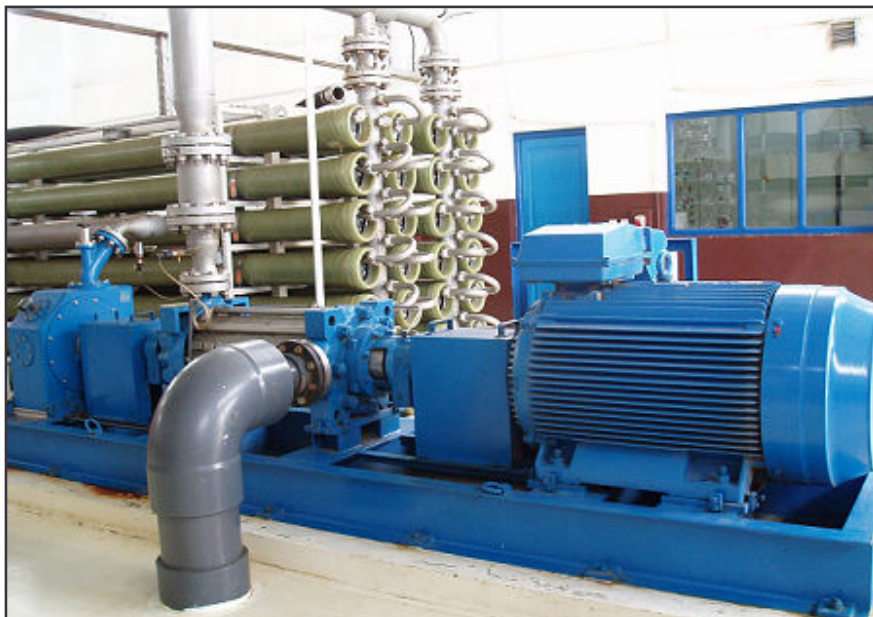
De gauche à droite :Turbine, pompe HP, moteur de la HP ,en arrière plan les membranes
