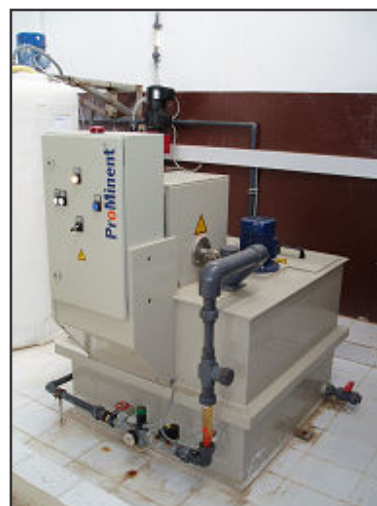
Dosage de l'acide sulfurique
