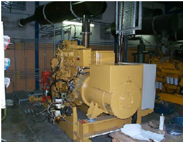
Figure II.7. Station de production d'électricité à huile du tournesol 300 kva, New Caledonia [20].
