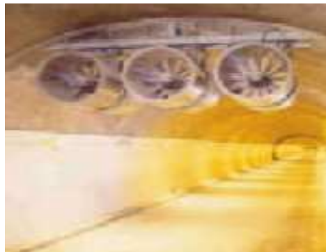
Fig. 2.4 Accélérateurs dans un tunnel ventilé longitudinalement
