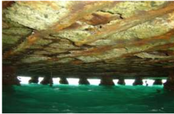
Figure I-4: Eclatement du béton dû à la corrosion des armatures
