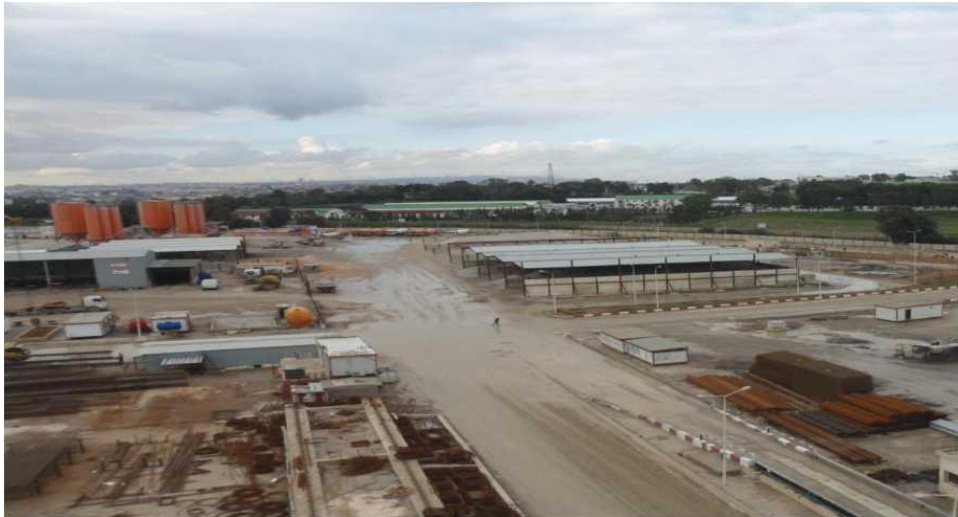
Figure 3. 7 Zones de stockage des granulats[13]
