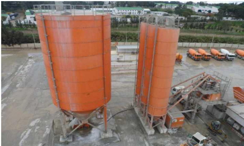
Figure 3. 6 Silos pour stockage du ciment
