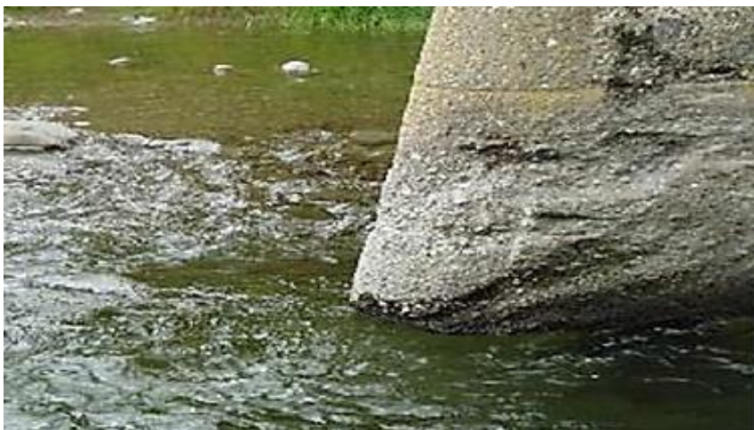
Figure I.12 : Abrasion du béton
