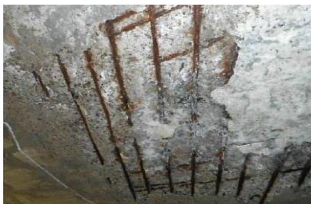
Figure I.9 : Eclatement dans une dalle
