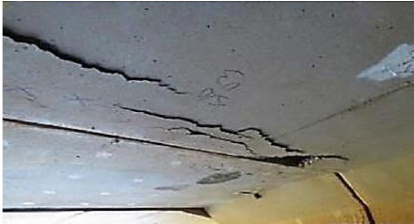
Figure I.11 : Délamination dans une dalle
