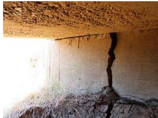
Figure I.7 : Fissures dans la culée dues à un tassement différentiel
