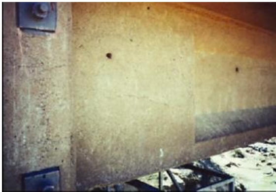
Figure I.8 : Fissures dans les zones d'ancrage
