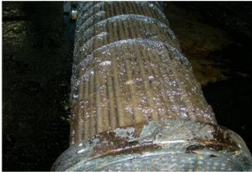
Figure 3-6 : Exemple d'un faisceau de tubes d'un échangeur encrassé [58].
