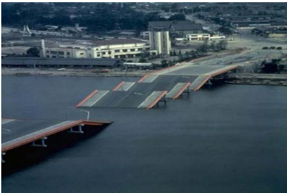
Figure 1 - 4 : Rupture du pont de Showa, à Niigata au Japon, dues à l'épandage latéral dans le sol (d'après Peter M. Byrne et al, 2008).
