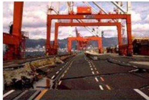
(b) Déplacement latéral d'un mur de quai, Port Island.
