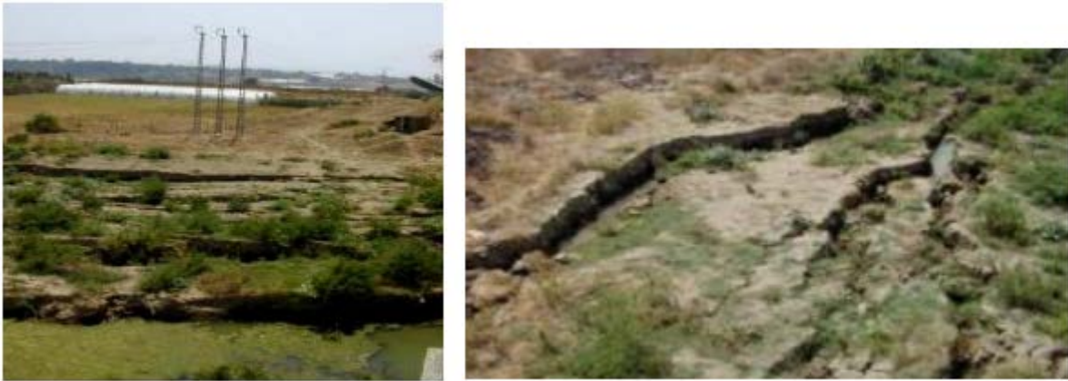
Figure 1 - 18 : Epandage latéral dû à Liquéfaction.
