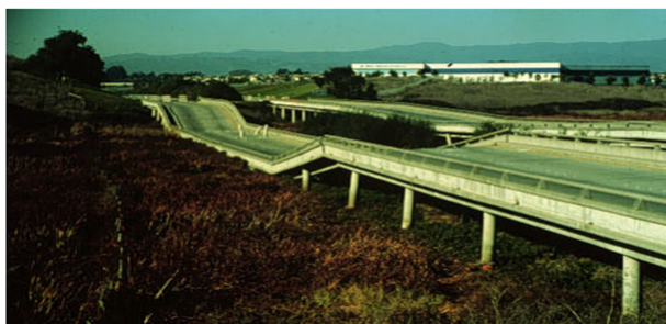
(a) Rupture du pont après la liquéfaction.
