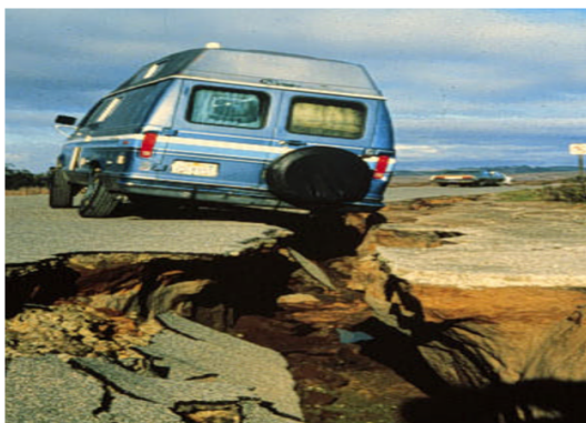
(a) Rupture routière induite par la liquéfaction
