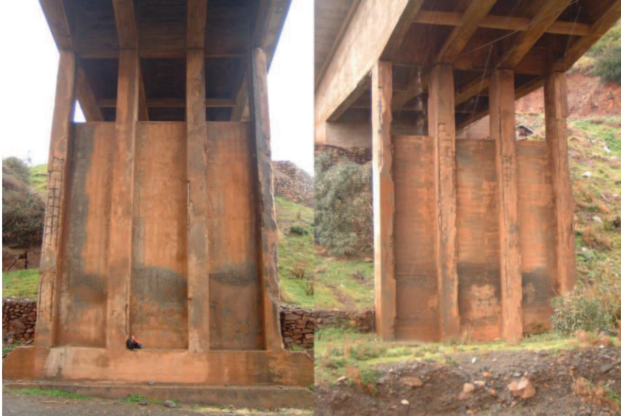
Figure V.2. Dégradations pile côté CHERCHELL à droite, pile coté TIPAZA à gauche [57]
