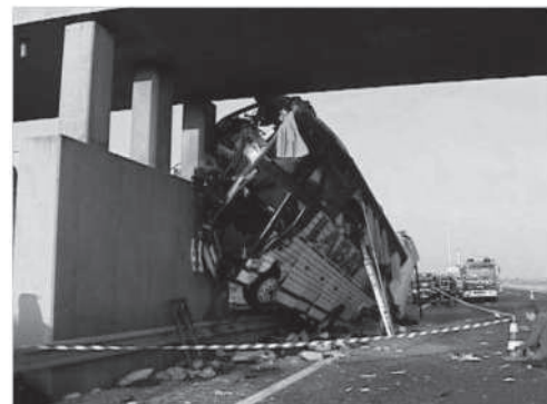
Figure I.6. Choc véhicules sur piles
