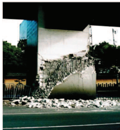
Figure 1.5. Rupture des piles par cisaillement séisme Hanshin-Awaji
