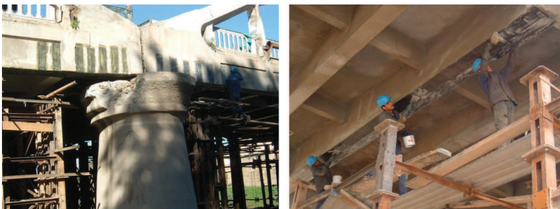
Figure II.19. Pont blanc d'El Harrach (Alger) avec dégradation au niveau de la pile [37]
