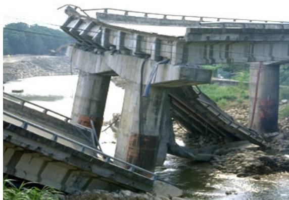
Figure 1.5: Effondrement du tablier d'un pont préfabriqué lors du tremblement de terre de Taiwan en 1995 [2]
