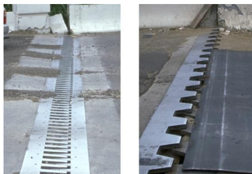
Figure 1.12 : Joints de chaussée endommagés après le tremblement de terre à Taiwan en 1999 [2]
