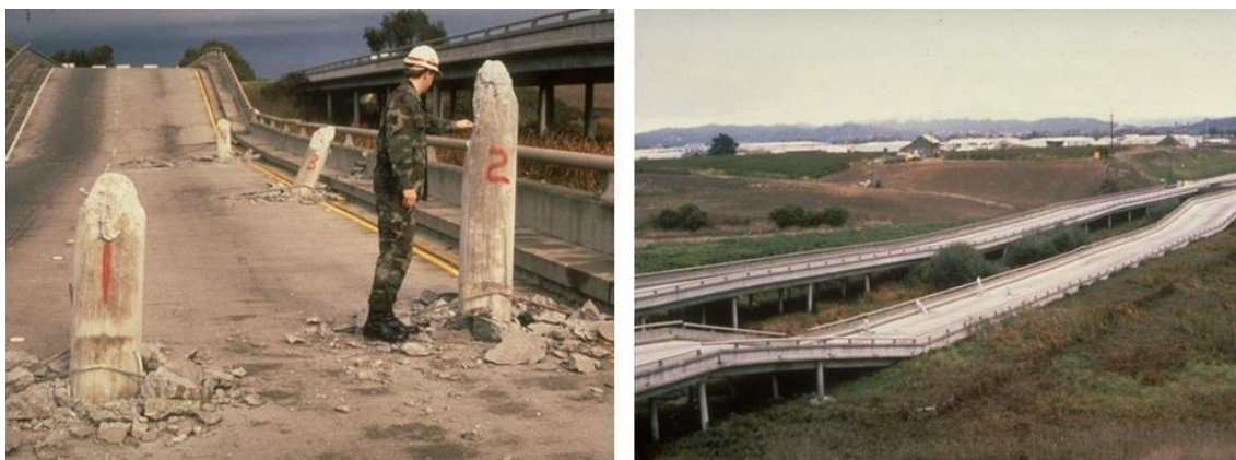
Figure 1.7 : Poinçonnement du tablier d'un pont sous l'effet de la composante verticale lors du séisme de Loma Prieta (USA, 1989) [2]
