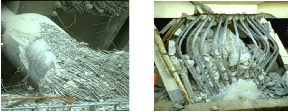
Figure 1.10 : Ruine de piles de pont en béton armé lors du tremblement de terre de Kobe en 1995 [2]
