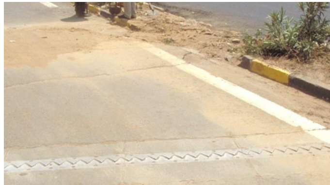
Figure 1.11 : Tassements faibles derrière la culée d'un pont-route à Boumerdès, 2003 [17]
