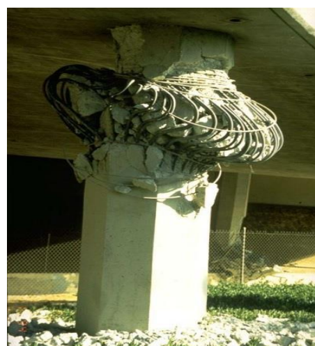
Figure 1.9 : Endommagement des piles lors du séisme de Northridge (USA, 1994) [2]
