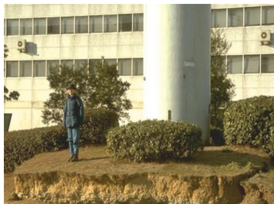
Figure 1.2: Tassements généralisés causés par la liquéfaction du sol autour de la dalle de fondation sur pieu d'une pile de pont, Kobe (1995) [2]
