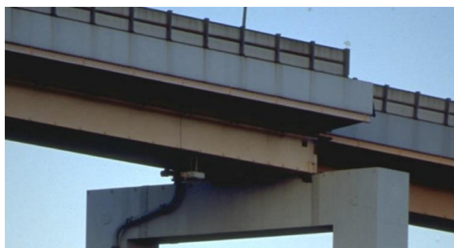
Figure 1.6 : Déplacement latéral du tablier et chute des appuis sur la palée d'un pilier à Kobe en 1995 [2]
