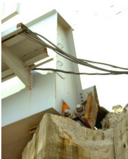
Figure 1.15 : Appui longitudinal arraché, sur la culée [3]
