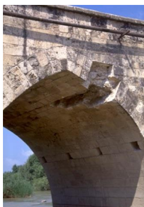
Figure 1.14 : pont-arc en pierres naturelles endommagé lors du tremblement [2]
