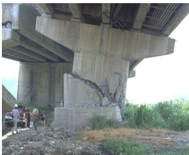
Figure 1.8 : Rupture des piles par cisaillement lors du séisme de Chi-Chi (Taiwan, 1999) [2]
