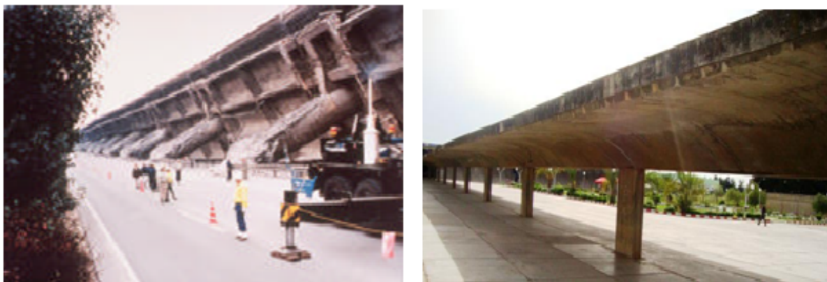
a) Effondrement d'une structure isostatique, Japon b) Structure très vulnérable au séisme, Alger (USTHB)
