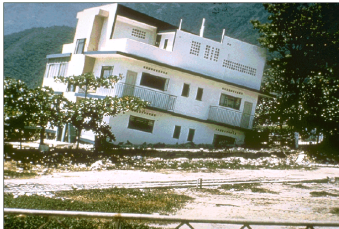
Figure 4.22: Enfoncement d'un bâtiment dû à la liquéfaction, Caracas 1967. (Balandier, 2001)
