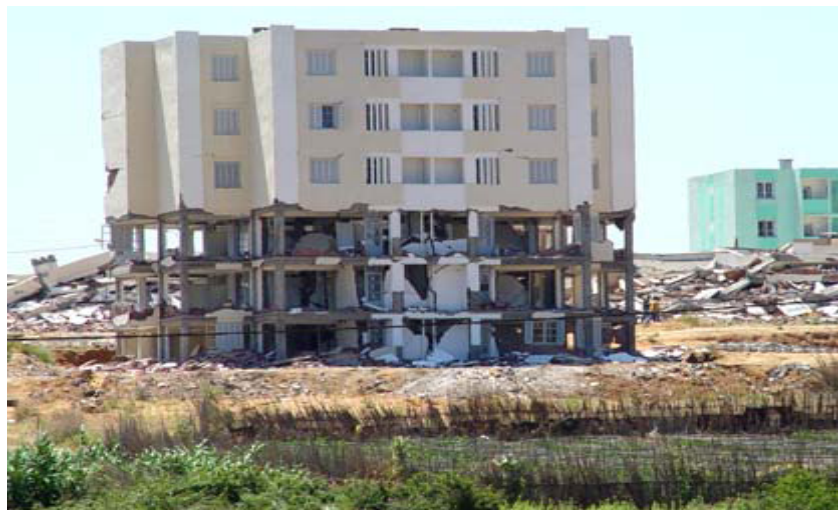
Figure 4.24: Portiques plus résistants que la maçonnerie, Boumerdes 2003.
