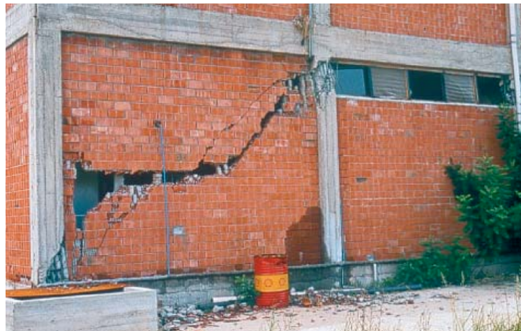
Figure 4.25: Maçonnerie plus résistante que les cadres, Turquie 1998.
