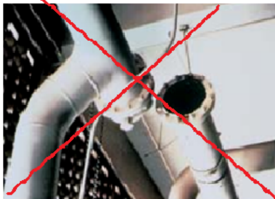
b) Equipement mal soutenu
