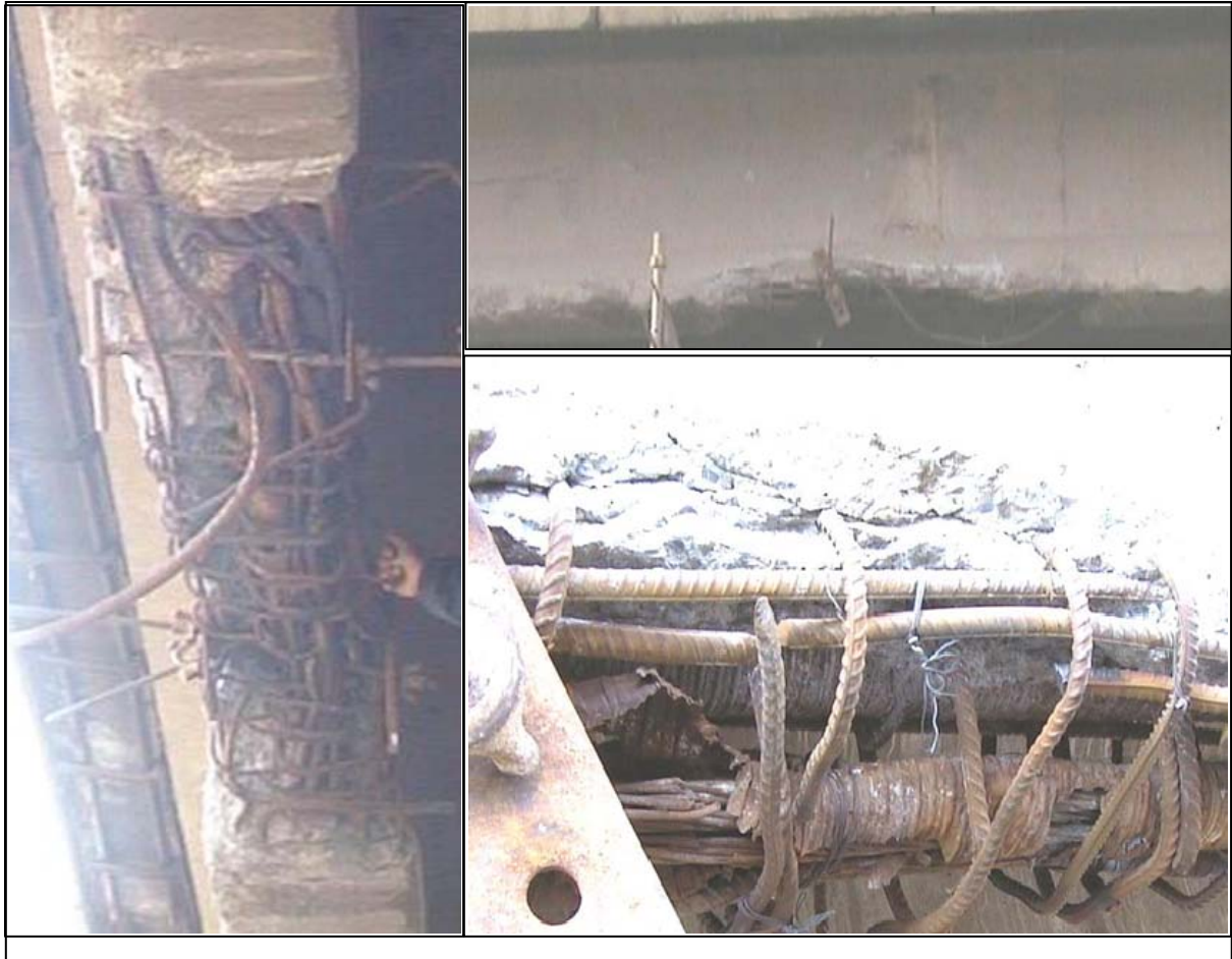
Figure 4-1 : Effets du choc sur la poutre
