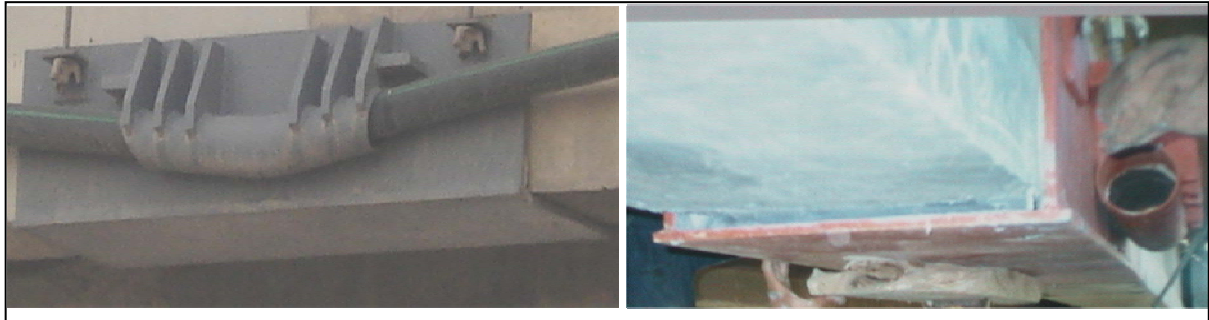
Figure 5-13 : Déviateur en place
