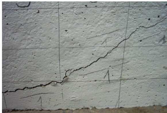
Figure 3.13a : Fissuration de la poutre 1 à la rupture
