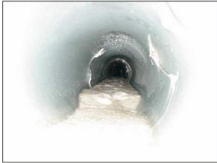
Figure I-5 Conduit avec une réduction importante par formation de glace.
