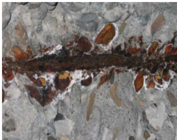
Figure I-4 Érosion mécanique et corrosion du ferrailage.
