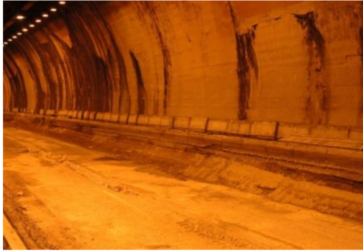
Figure I-3 Taches sur le revêtement.
