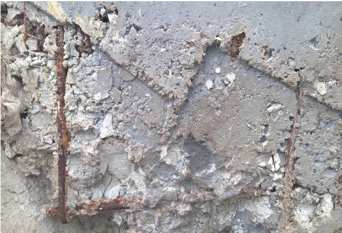
Figure IV.10: Ségrégation du béton et dénudement des armatures.
