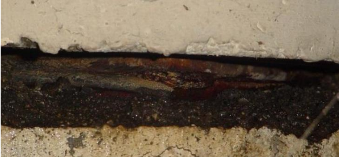
Figure IV.6: Corrosion très importante des frettes.
