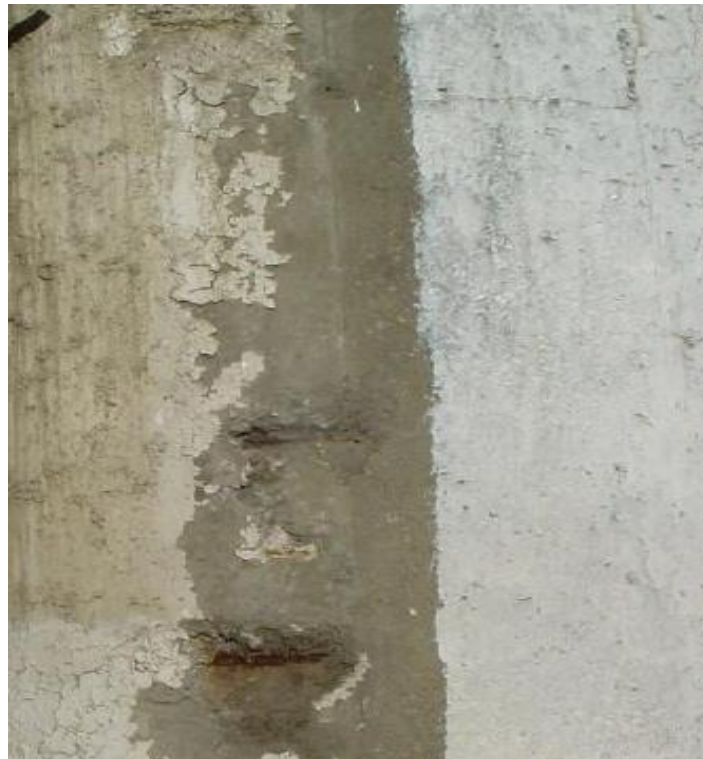
Figure IV.5: Éclatement du béton et corrosion des armatures de la pile.
