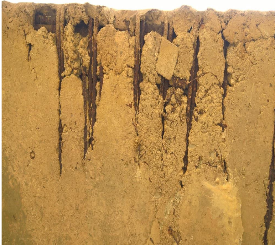
Figure IV.11: Fissuration du béton et armatures corrodées.
