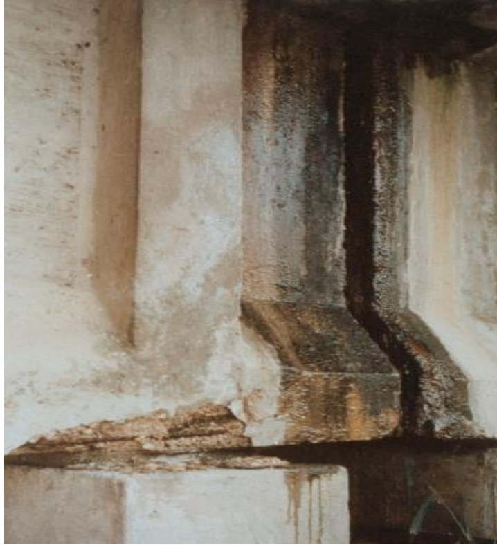
Figure IV.4: Armatures de la poutre de rive dénudée.
