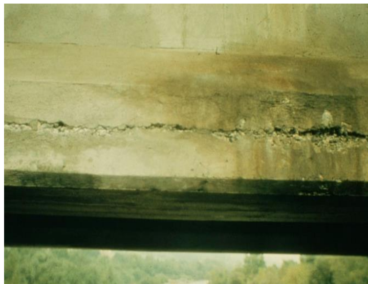
Figure IV.3: Poutre de rive fissurée.
