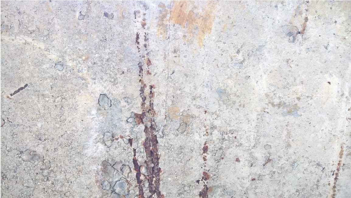
Figure IV.9: Absence d'enrobage et corrosion des armatures des piles.
