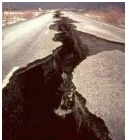
Figure 1 - 6 : Rupture latérale, un signe évident de liquéfaction.
