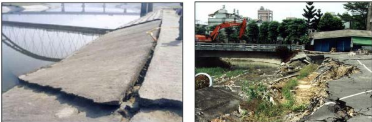
Figure 1 - 13 : Dommages dus à l'épandage latéral du sol en place.
