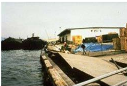
(a) Endommagement du mur de soutènement.
