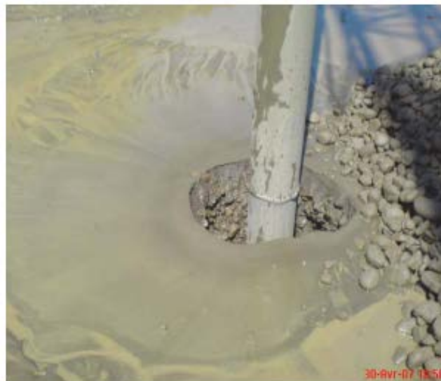
Figure 3 - 5 : Phénomène de liquéfaction local.
