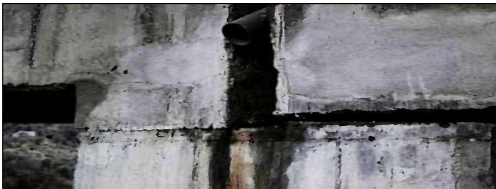
Figure I.16 : évacuation d'eau mal conçue.
