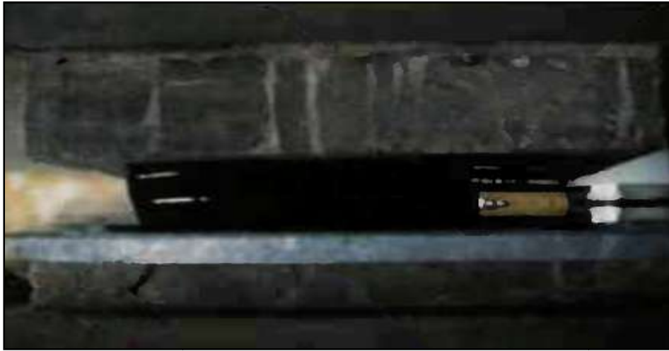
Figure II.6 : écrasement d'un appareil d'appui.
