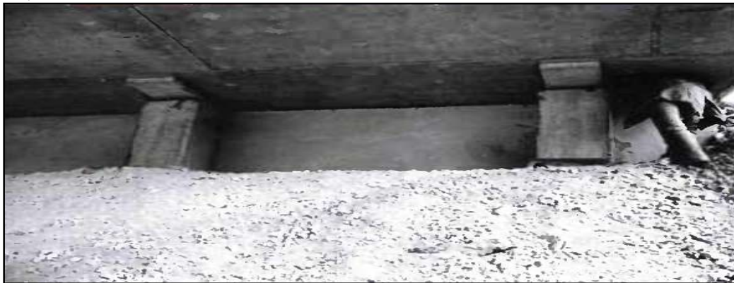
Figure I.13 : Accès aménagé pour effectuer la visite des appareils d'appui.
