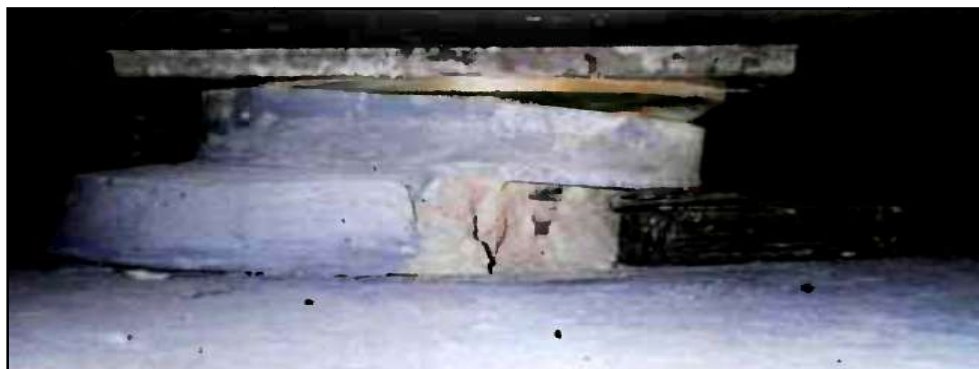
Figure I.15 : bossage éclaté sous un appareil d'appui à pot nécessitant un traitement d'urgence.
