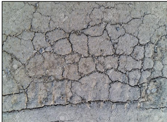
Figure 1.11. Fissures en carrelage [54]
