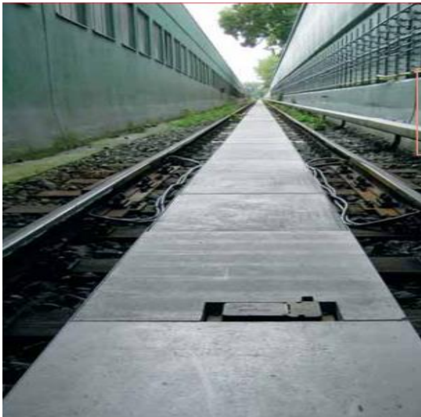
Fig12 : Plaques de protection contre le feu à côté de la voie ferrée
