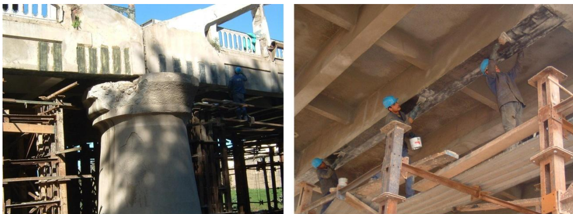
Figure I.6. Pont blanc d'El Harrach (Alger) avec dégradation au niveau de la pile [15]
