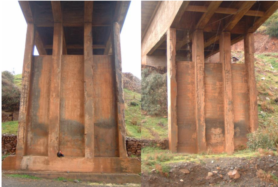
Figure II.2. Dégradations pile côté CHERCHELL à droite, pile coté TIPAZA à gauche [28]
